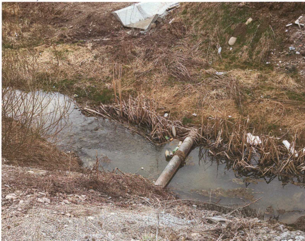
Fig. 14 Subtraversare executată necorespunzător
