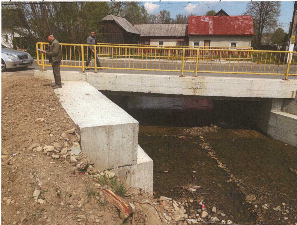
Fig. 4 Tronson CM 181 – CM 186 (subtraversare pârâu) deteriorat
