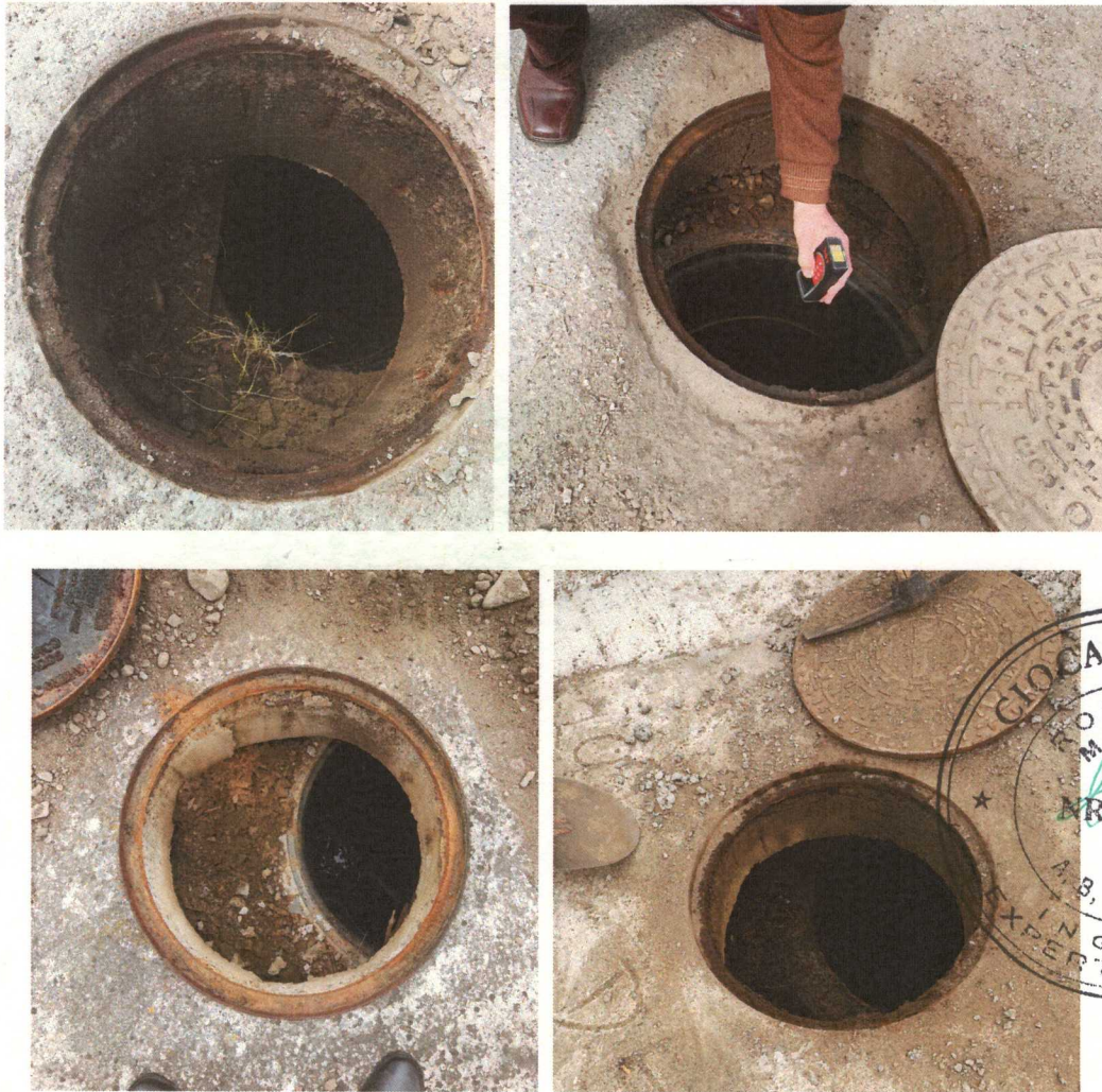
Fig. 12 Plăci cu rame și capace montate necorespunzător
