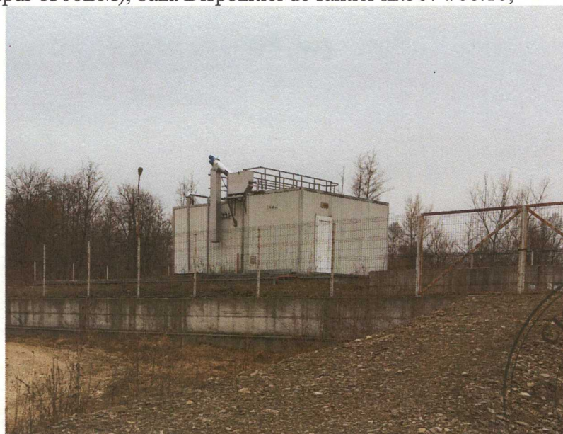
Fig. 16 Stația de epurare
